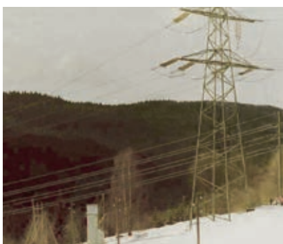
Die 220-kV-Leitung im Höllental.
